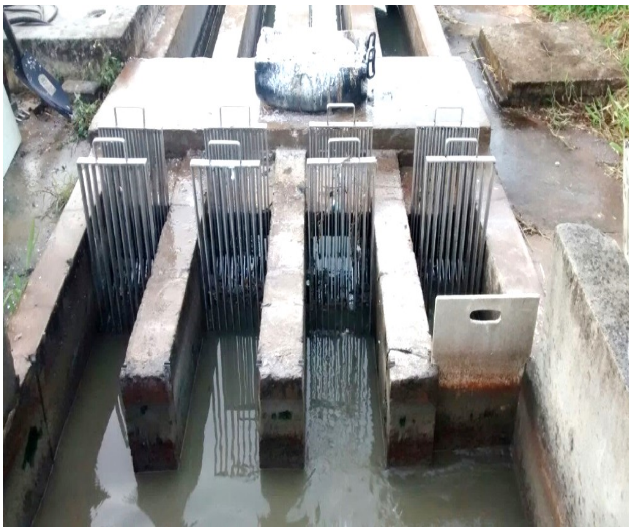
Figura 225 – Sistema de gradeamento da ETE Vila Flora
